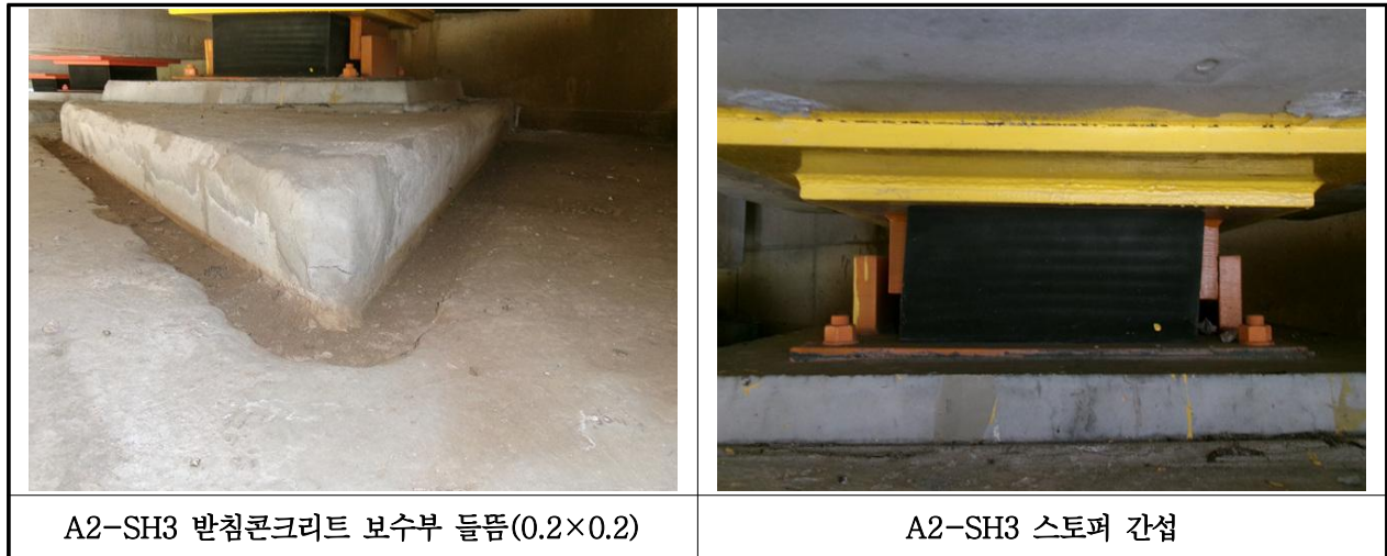
【사진 32.3.13】 교량받침 손상현황
