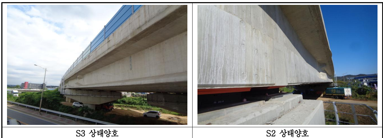
【사진 32.3.5】 거더 손상현황
